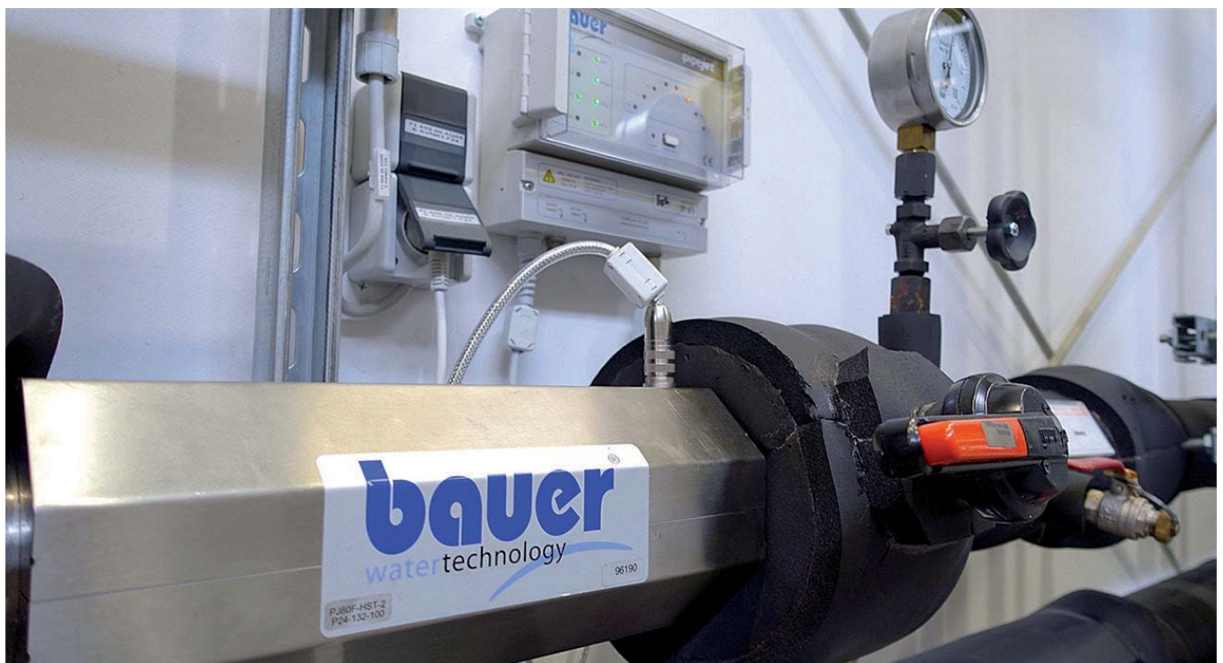
Einbau im zentralen Vorlauf: Wasserbehandlung mit Steuergerät
